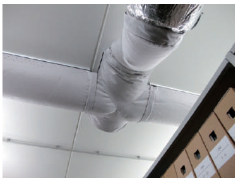
Nawiew wentylacji w magazynach przewodami wykonanymi z płótna i włókna zapewnia równomierne rozprowadzenie świeżego powietrza. Przewody są prane raz do roku. Archiwum Regionu Rivierenland w Tiel (Regionaal Archief Rivierenland), Holandia
