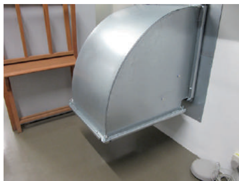
Odbiór powietrza w magazynie poprzez przewody umieszczone tuż przy podłodze magazynu archiwaliów. Taka konfiguracja zapobiega unoszeniu zanieczyszczeń z podłogi i rozprzestrzenianiu ich w magazynie. Archiwum Regionu Rivierenland w Tiel (Regionaal Archief Rivierenland), Holandia
